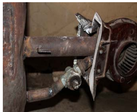
Рис. 6. Вентилятор і засоби регулювання
