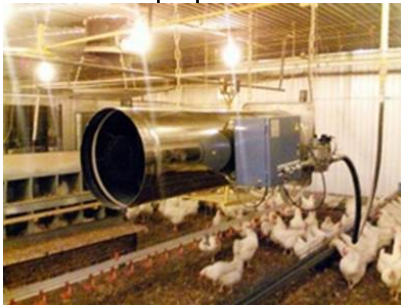
Рис. 16. Застосування газового теплогенератора для обігріву
