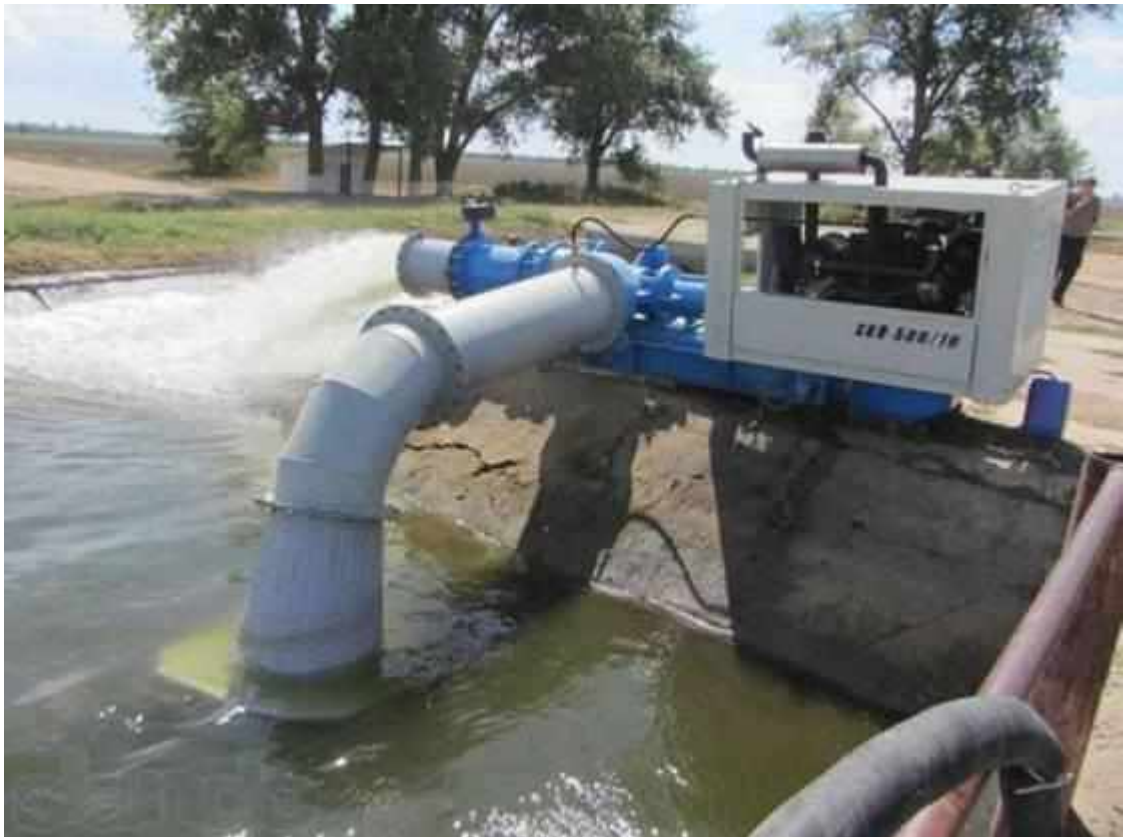
Рис. 6. Дизельна насосна станція СНП-500/10
